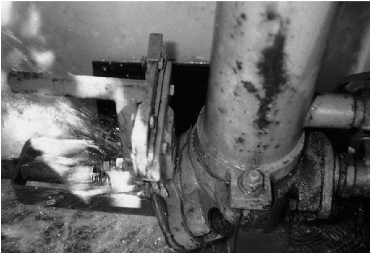
Der Hydraulische Widder in der Praxis. Er versorgt die Alpe »Priedler« mit 6200 Liter Wasser. Jeden Tag ohne Fremdenergie. [13]
